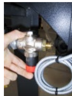
Sprinklerventil med afmonteret slange
