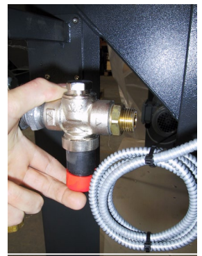
Sprinklerventil med afmonteret slange
