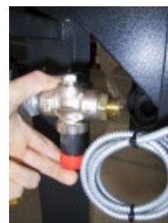
Sprinklerventil med afmonteret slange
