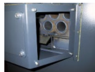
Røggasse med afmonteret renslem
